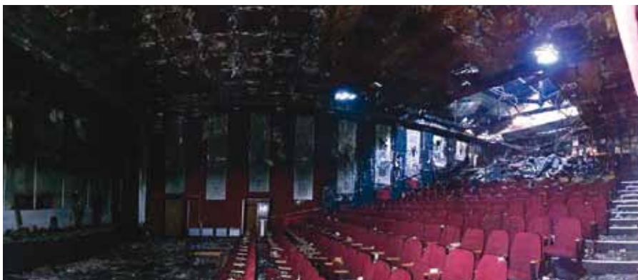
Один из залов ТРЦ "Зимняя вишня" после пожара
