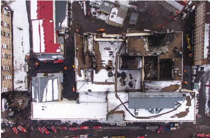
Обрушение кровли в ТРЦ "Зимняя вишня"
