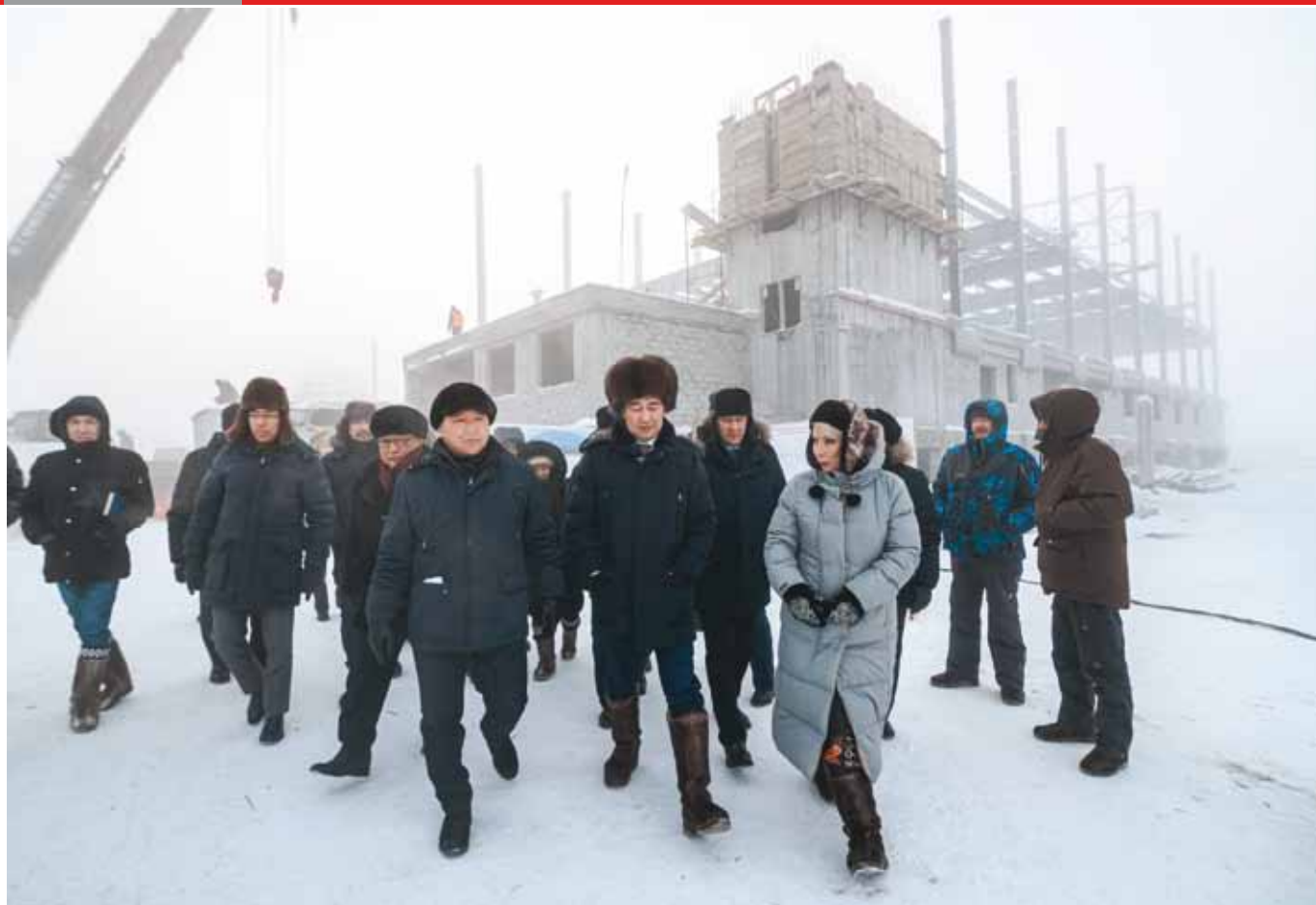
Глава Якутии Айсен Николаев на осмотре хода строительства спортивного комплекса с бассейном в Нижнем Бестяхе. Пресс-служба Министерства строительства РС(Я)
