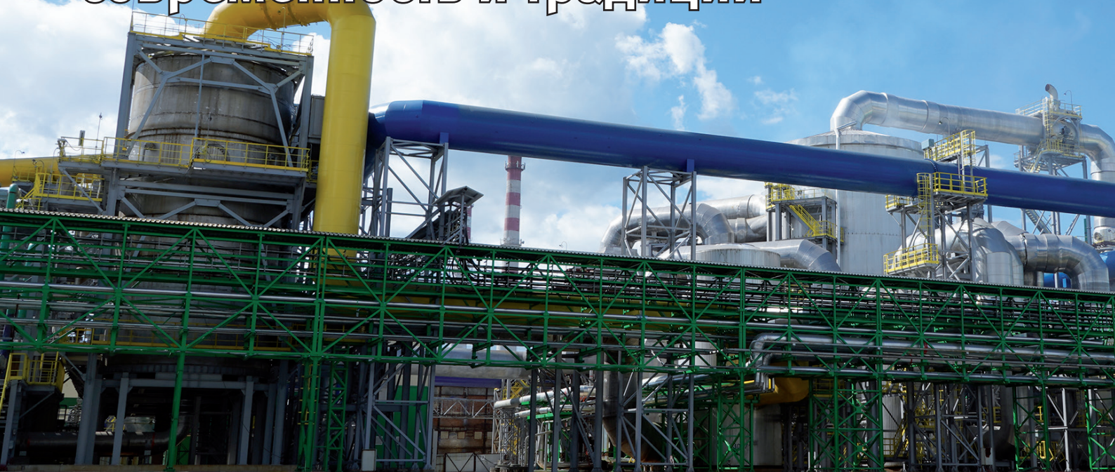
Установка по производству Серной кислоты, г. Череповец
