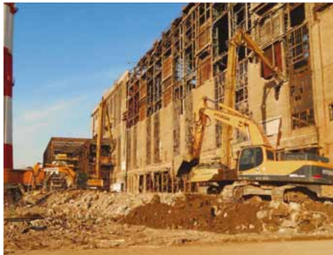
г. Кстово (Нижегородская обл). Демонтажные работы в рамках проекта расширения Новогорьковской ТЭЦ
