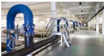
Зал фильтров на Западной станции водоподготовки
