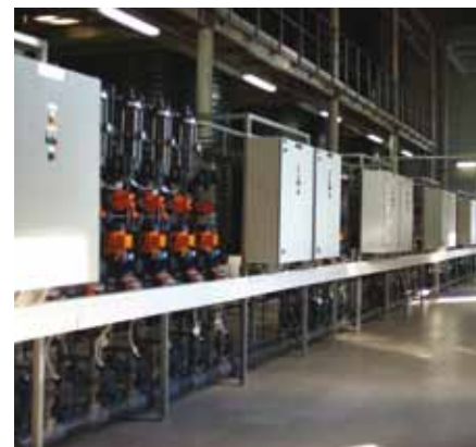
Склад ГХН. Узел дозирования. Рублёвская станция водоподготовки
