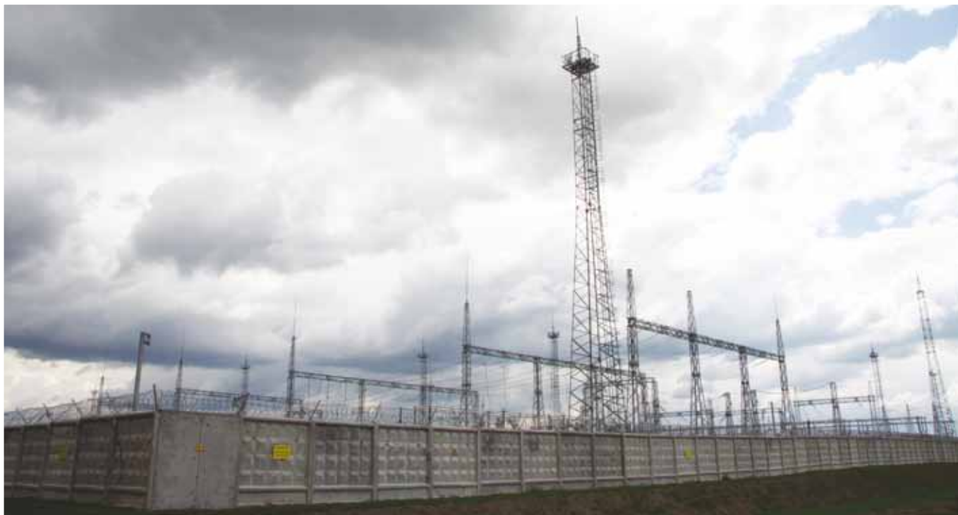
Подстанция 500 кВ "Белобережская" в Брянской области
